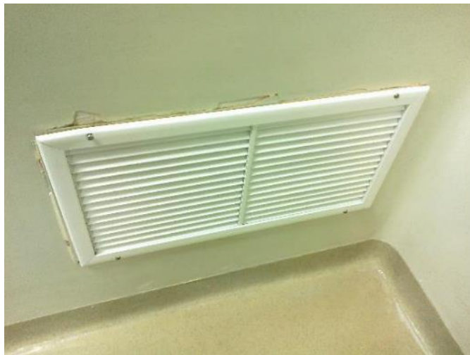
Figura 30. Rejilla en mal estado
