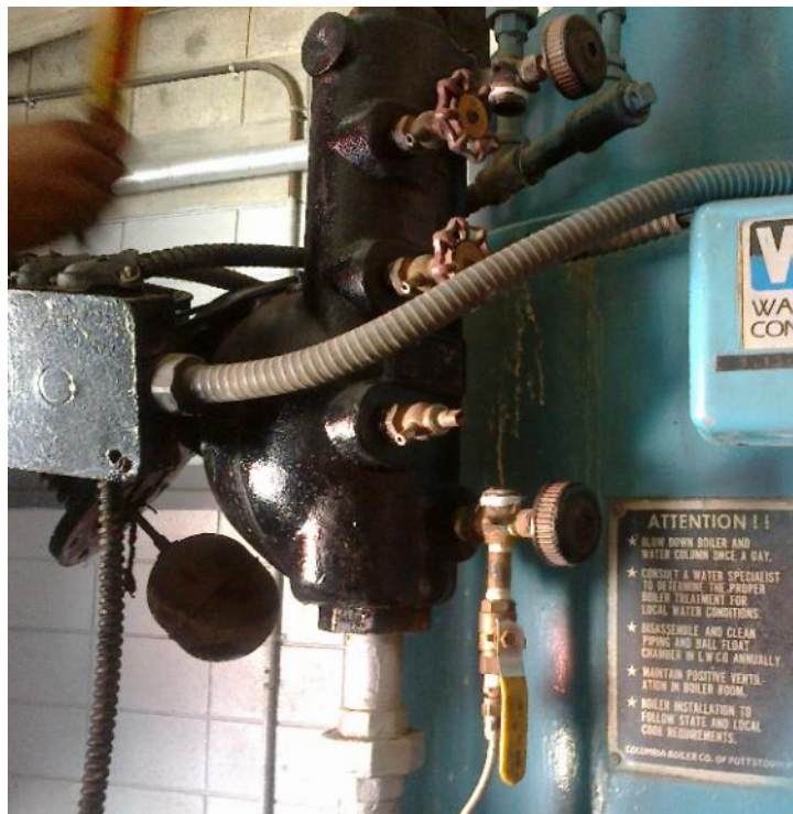
Figura 129. Control de agua bajo limpieza
