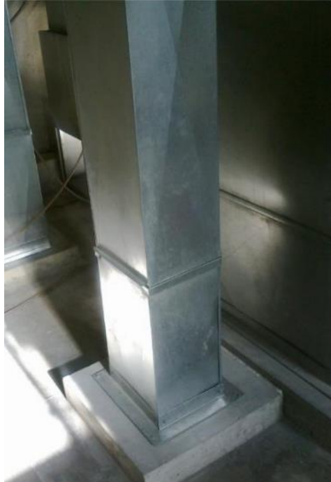
Figura 31. Soporte de ducto
