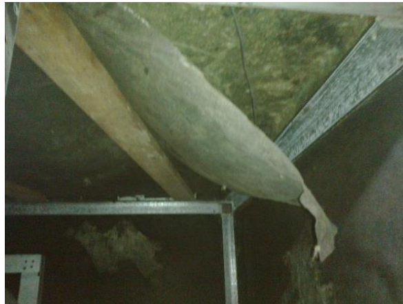
Figura 41. Aislamiento en mal estado
