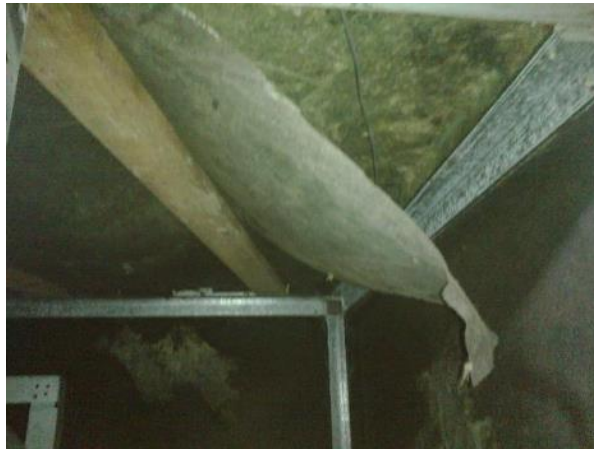
Figura 124. Aislamiento interior en mal estado
