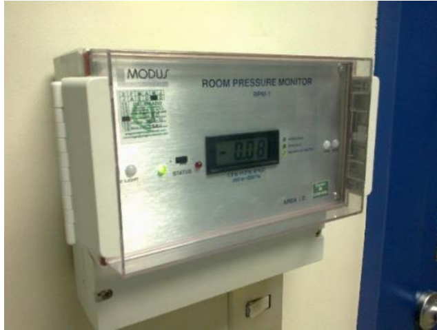
Figura 97. Monitor de presión diferencial (II)
