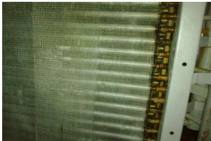
Figura 40. Fugas en el serpentín
