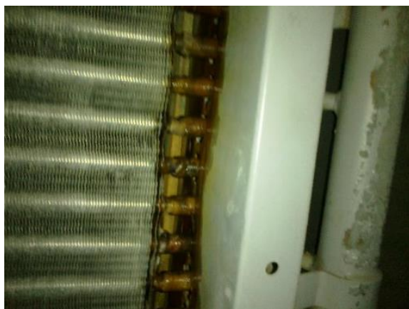
Figura 123. Fugas en el serpentín
