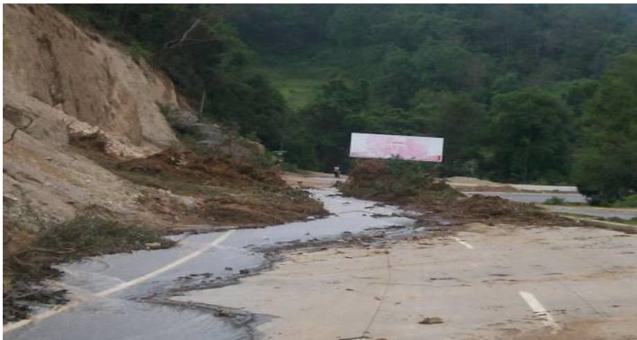
Figura 5. Visión de la correntada de agua sobre la pista al producirse el colapso de la tubería
