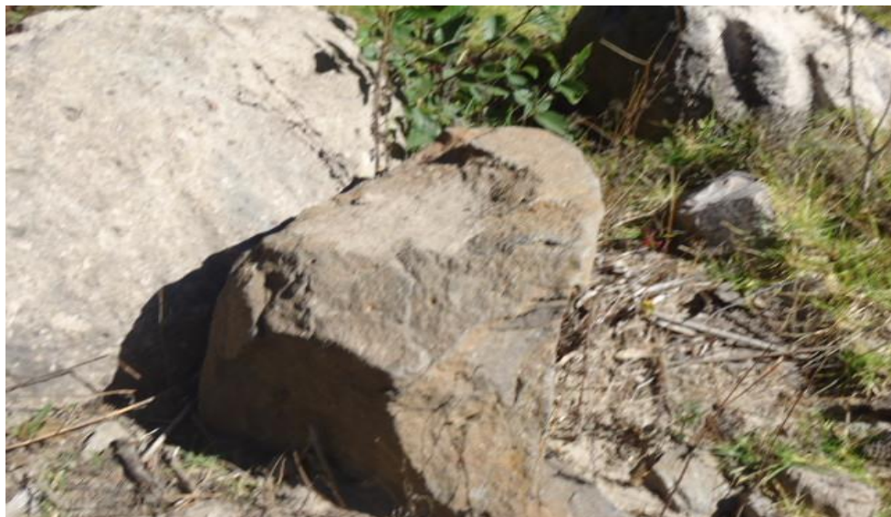
Figura 6. Rocas desprendidas de talud adyacente
