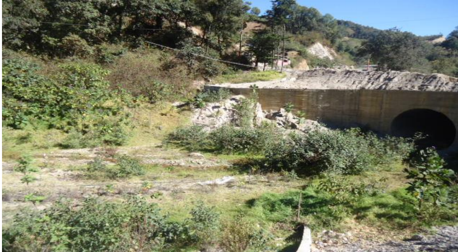
Figura 4. Material de arrastre que provoca el taponamiento
