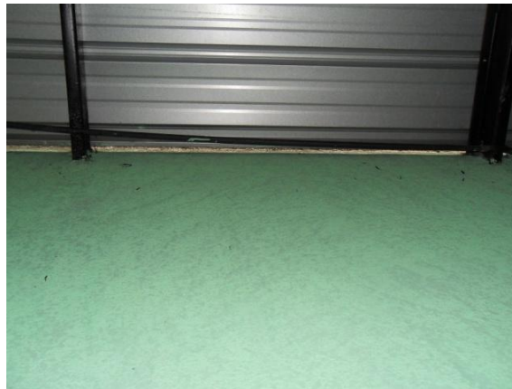
Figura 51. Pequeña abertura entre la pared y el techo del laboratorio
