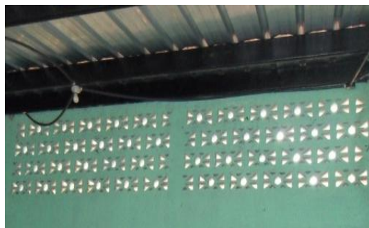
Figura 50. Ventilación actual en la pared norte del laboratorio
