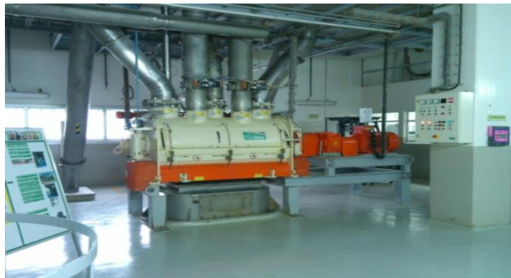
Figura 6. Mezcladora del centro de mezclas
