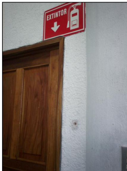
Figura 50. Áreas sin extintores
