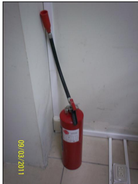
Figura 49. Extintores mal ubicados
