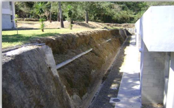
Figura 72. Fotografía de taludes inestables
