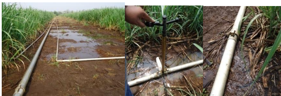
Figura 9. Puntos observados en la tubería principal y ramales con fuga de agua.
