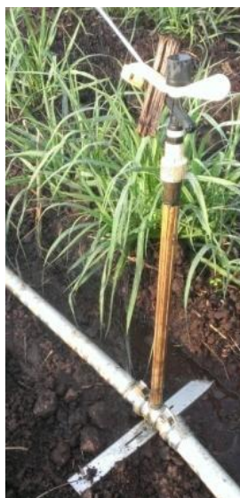
Figura 4. Aspersor instalado en el campo.
