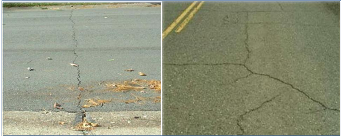
Figura 6. Fisuración por baja temperatura
