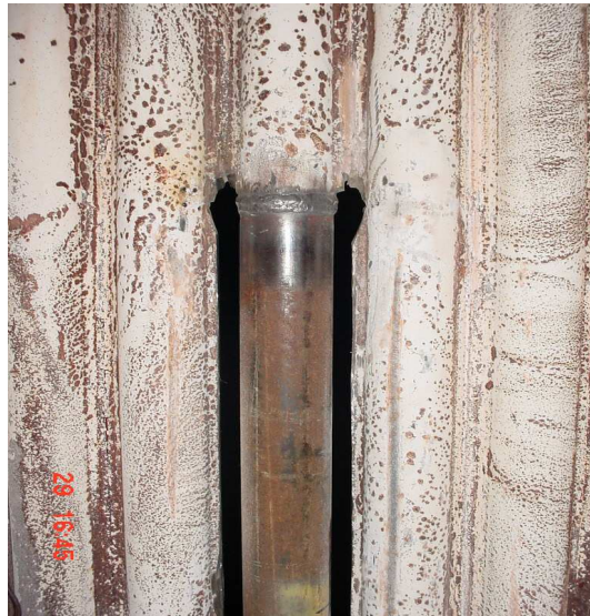
Fuente: tubería soldada, pared de caldera
