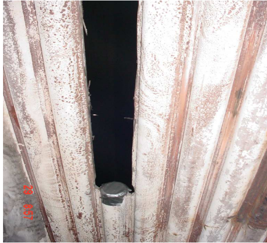
Fuente: pared de caldera, planta san José
