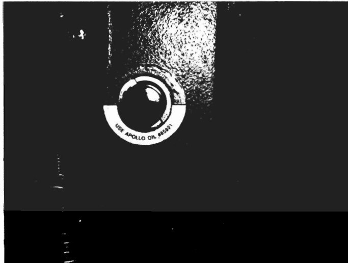
Puede apreciarse el nivel correcto de aceite en el compresor.
