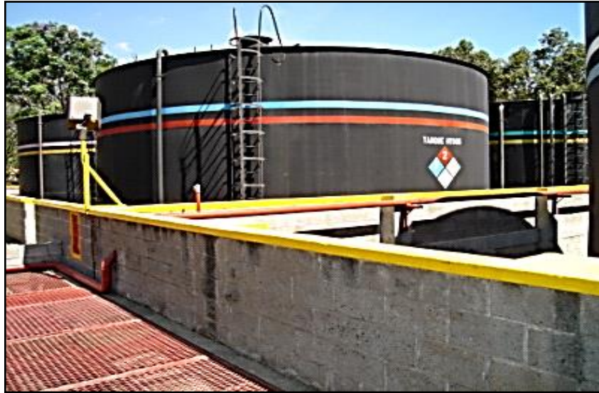
Figura 5. Tanque de almacén de bunker
