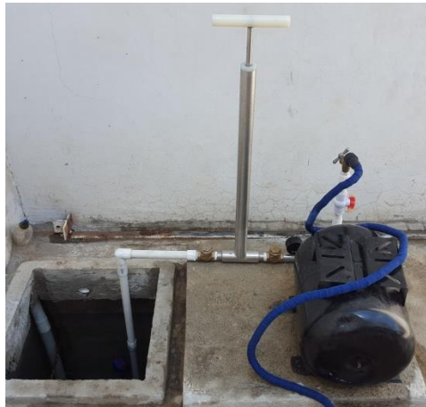
Figura 16. Pruebas de características de operación
