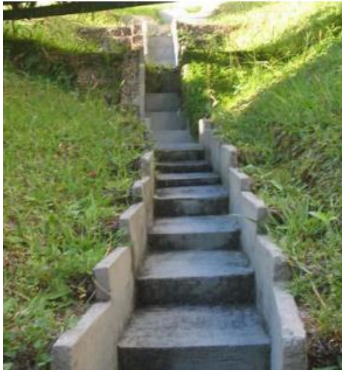
Figura 15. Canal de rpidas escalonadas
