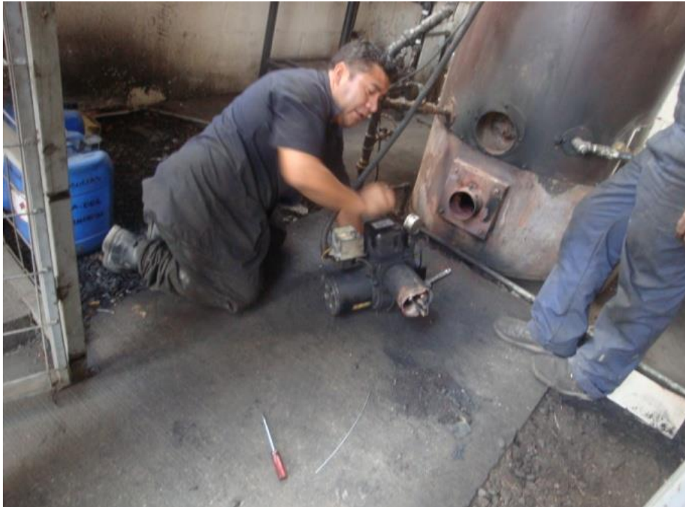
Figura 18. Mantenimiento a la caldera
