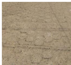
Figura 8. Calle de adoquín en regular estado.
