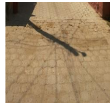
Figura 9. Calle de adoquín en mal estado.
