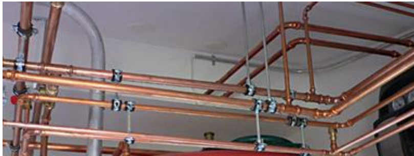
Figura 50. Tuberías de cobre
