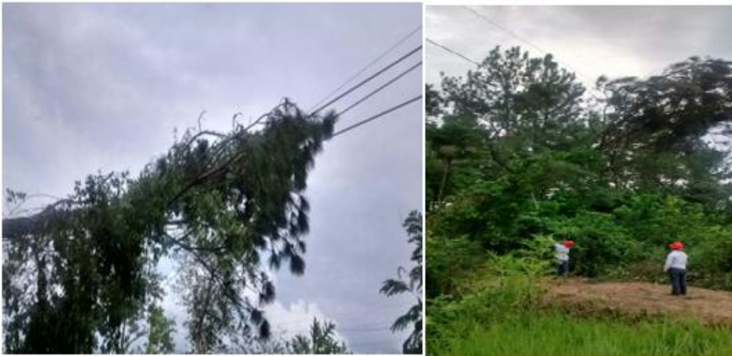
Figura 28. Árbol cortado cae sobre la línea de transmisión
