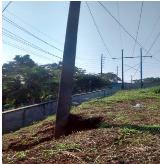
Figura 24. Estructura en riesgo deslave
