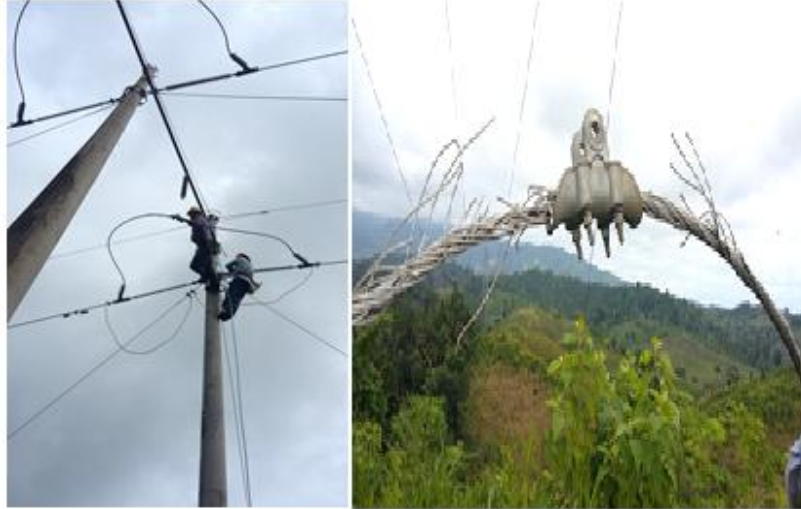
Figura 27. Daño en el conductor
