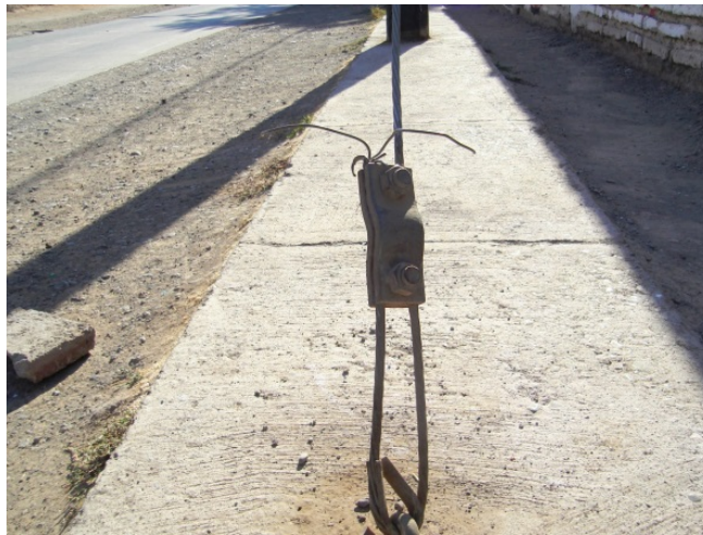
Figura 12. Tensor de cable eléctrico
