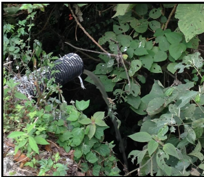
Figura 18. Efluente de la PTAR Chichorin desembocando al Río Sacurún.
