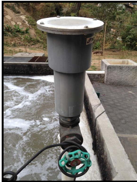
Figura 16. Respiradero de bomba aireadora del tanque de aireación, PTAR Chichorin.
