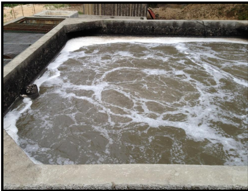
Figura 13. Tanque de Aireación con base en Lodos Activados, PTAR Chichorin.
