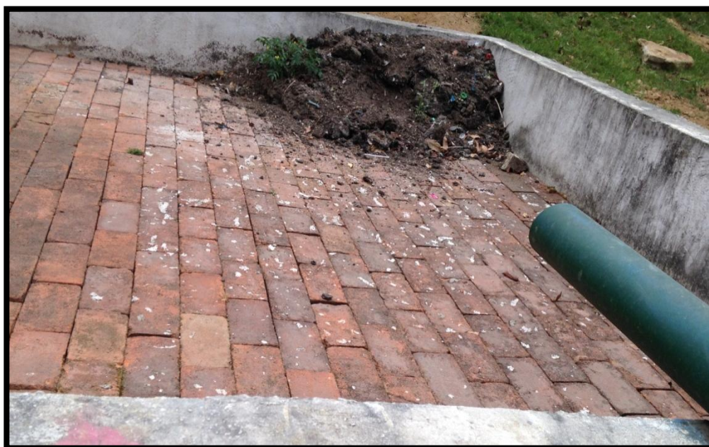
Figura 14. Patios de Secado de Lodos, PTAR Chichorin.
