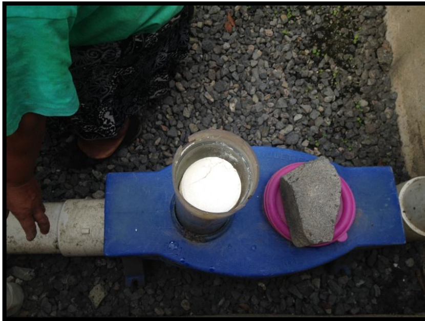
Figura 19. Dosificador de cloro en pastillas, PTAR Chichorin.
