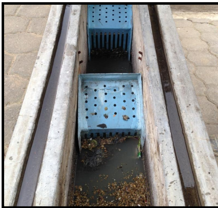
Figura 10. Rejillas de retención de sólidos, PTAR Chichorin.
