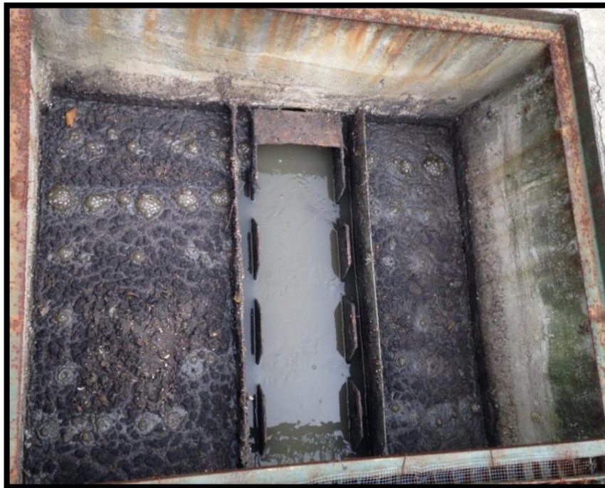
Figura 12. Tanque de Digestor de Lodos, PTAR Chichorin.
