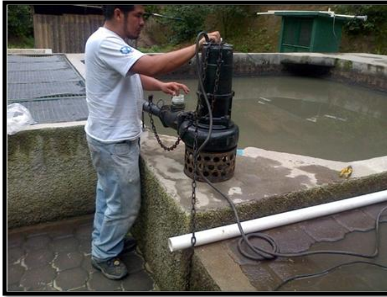
Figura 15. Bomba aireadora del tanque de aireación, PTAR Chichorin.
