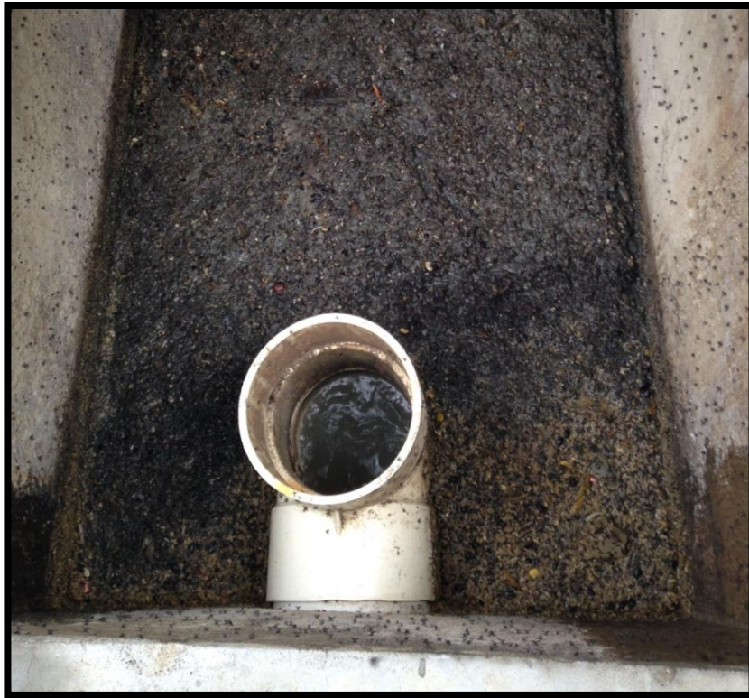
Figura 11. Tanque de Igualación y Homogenización, PTAR Chichorin.
