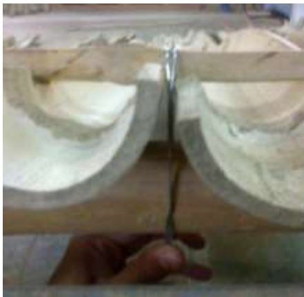
Figura 53. Sujeción de pasador y estructura de soporte de cubierta de techo con alambre galvanizado
