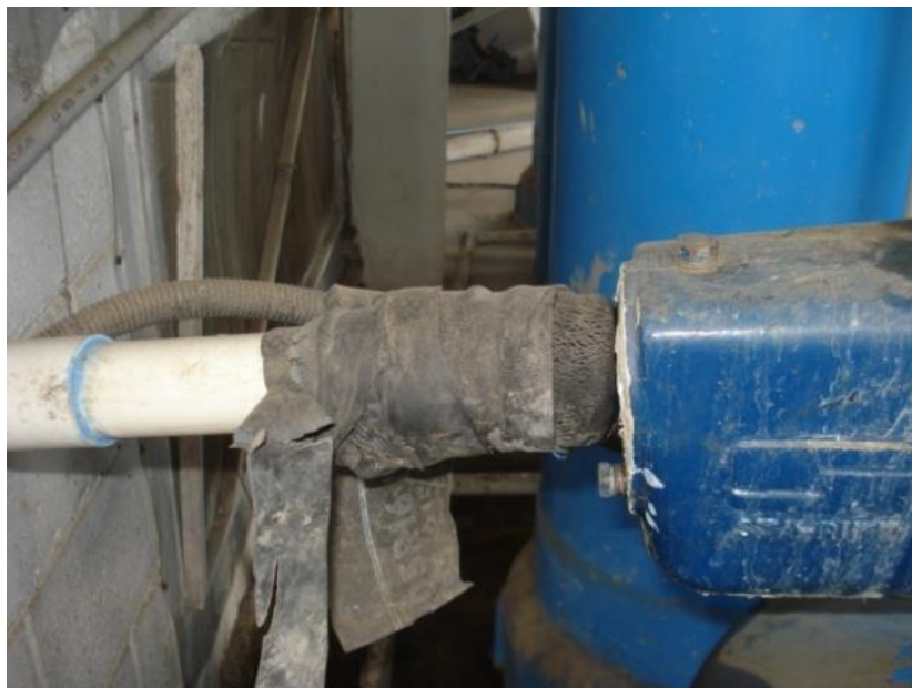
Figura 37. Tuberías en mal estado
