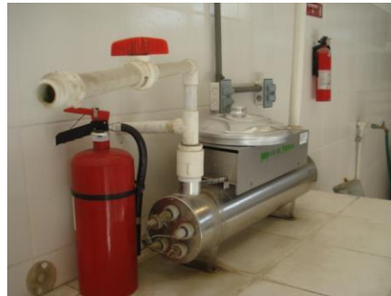
Figura 29. Filtro de agua UV
