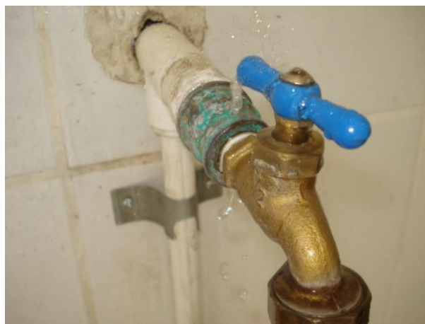
Figura 36. Chorro con fuga de agua
