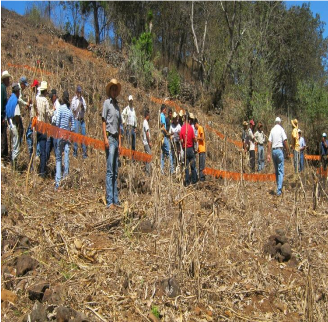
Figura 26A. Practica demostrativa sobre construcción de barreras muertas haciendo uso de la piedra acumulada en los terrenos.
