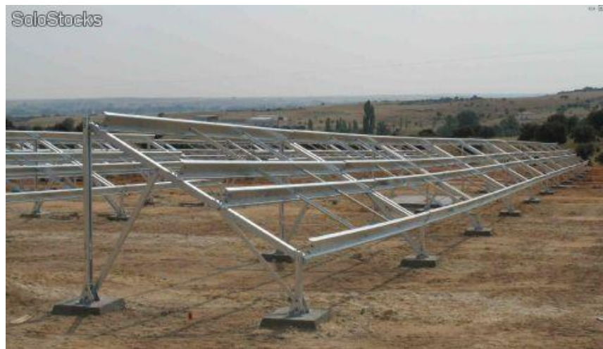
Figura 25. Estructura para paneles fotovoltaicos
