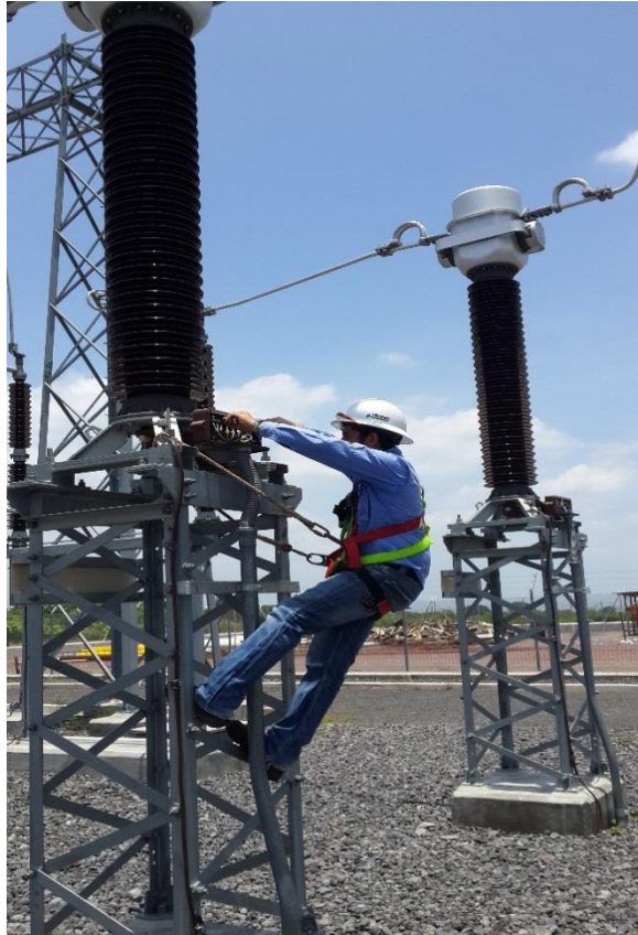
Figura 69. Verificación de cableado transformador de corriente
