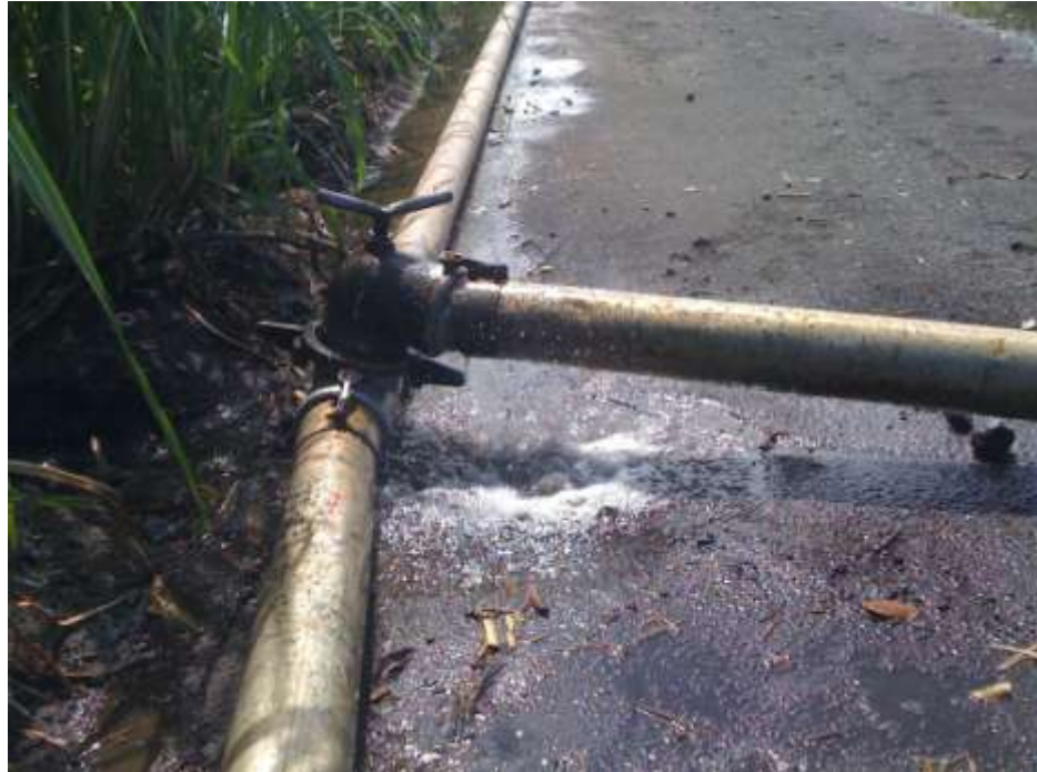
Figura 18. Fugas en el sistema de distribución de agua para riego.
