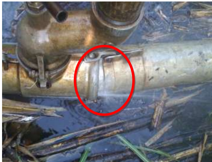
Figura 3. Fuga de agua en un sistema de riego por aspersión.
