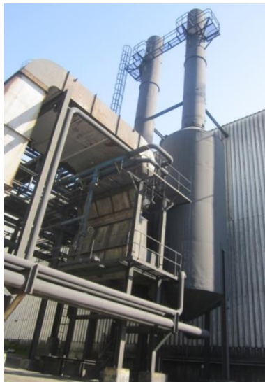
Figura 18. Sistema de lavado de gases de combustión, caldera # 5
