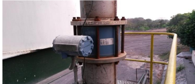
Figura 85. Instalación de transmisor de flujo de agua con cenizas
