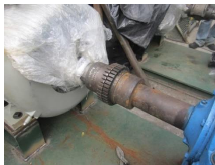
Figura 68. Alineación de bomba # 1 son su motor eléctrico
