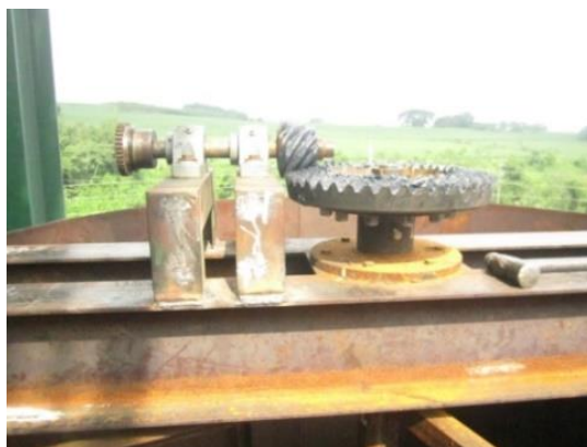
Figura 47. Mecanismo del agitador de lechada de cal
