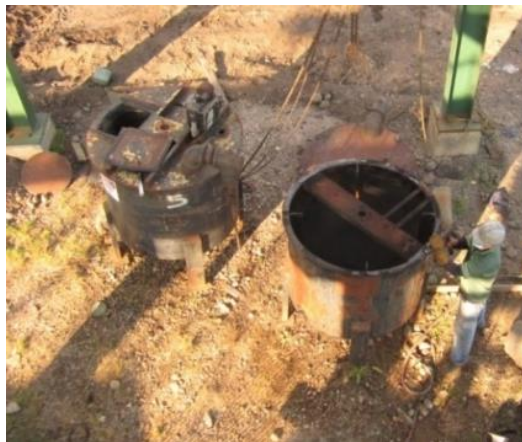
Figura 48. Bases de dos de los tres tanques para floculante
