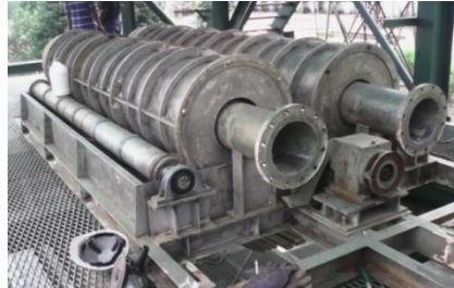
Figura 54. Instalación de filtros rotativos
