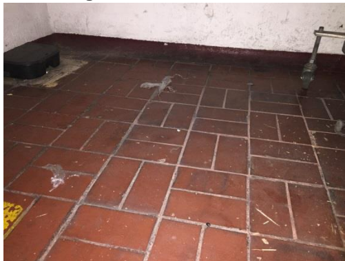
Figura 1. Piso sucio del área
