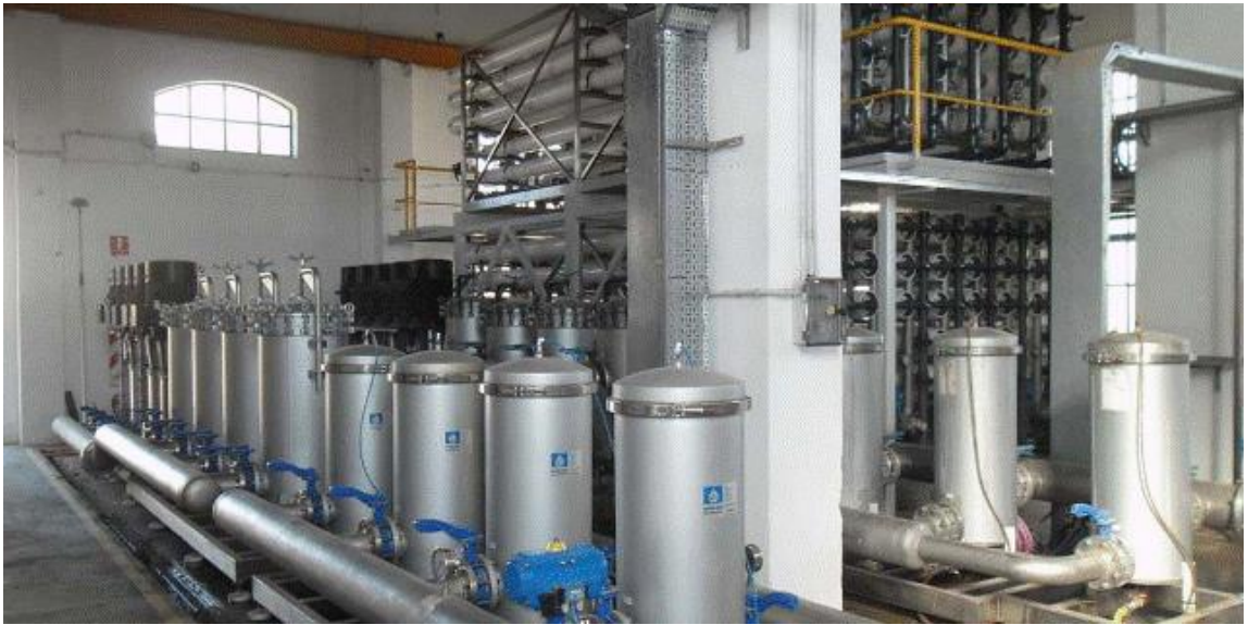
Figura 1. Planta de tratamiento potabilizadora de agua
