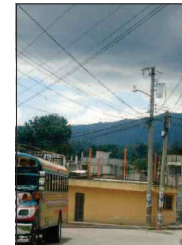
POSTES ELECTRICIDAD MUNICIPAL UBICACIÓN DE TRANSFORMADOR DE 50 KV. UBICADO LADO SUR DEL TERRENO
