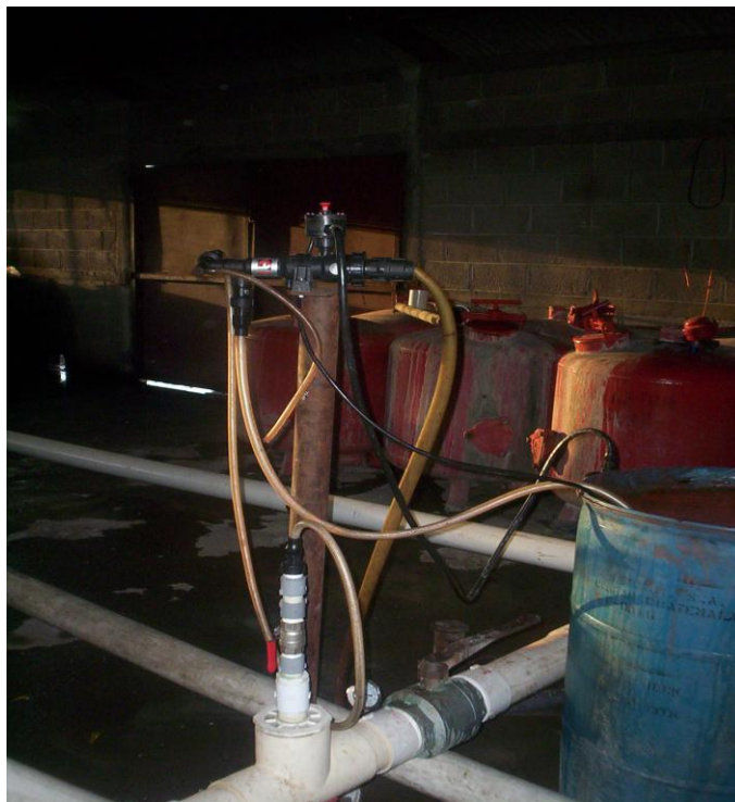
Figura 12. Equipo para aplicación de fertiriego
