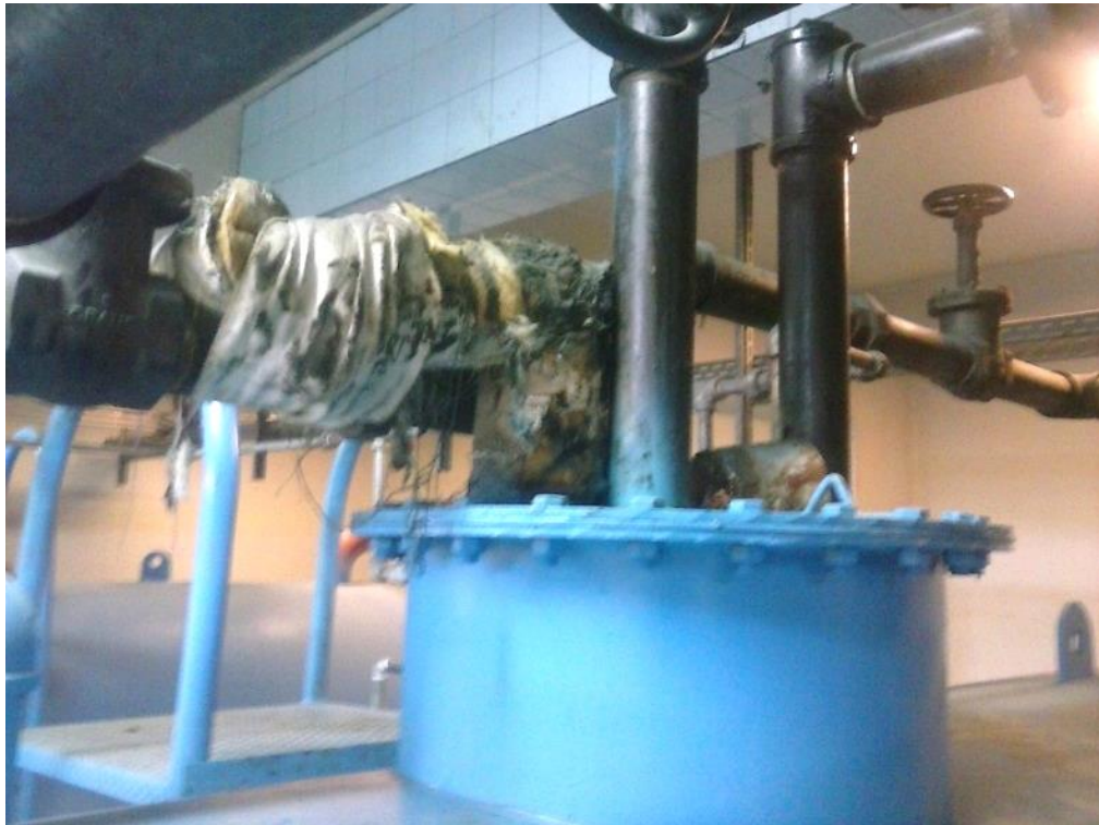
Figura 16. Tubería saliente de la caldera con aislante en mal estado
