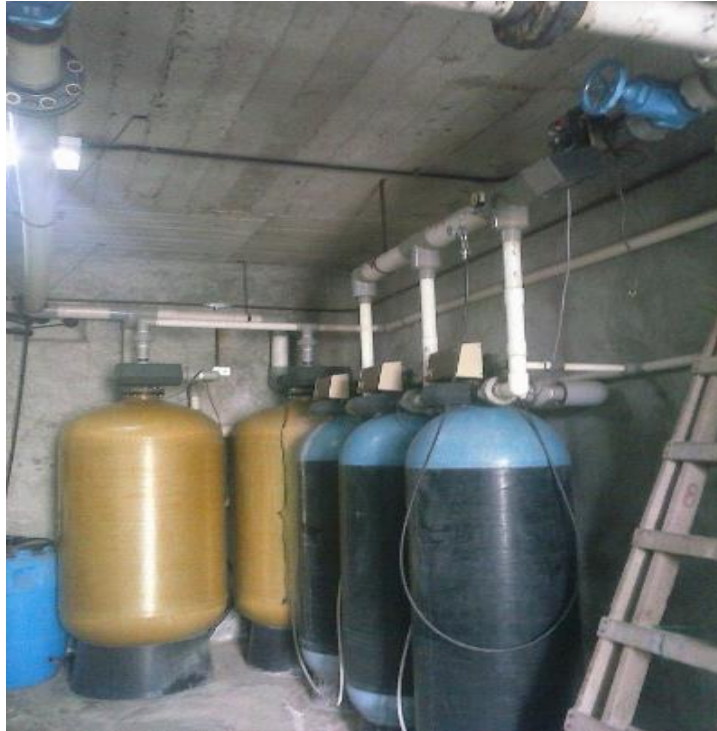
Figura 13. Sistema de suavizadores sin funcionamiento
