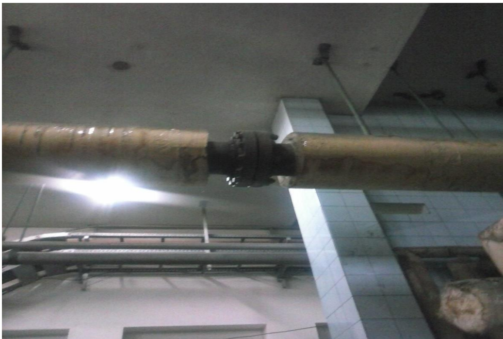
Figura 29. Tubería principal protegida por aislante
