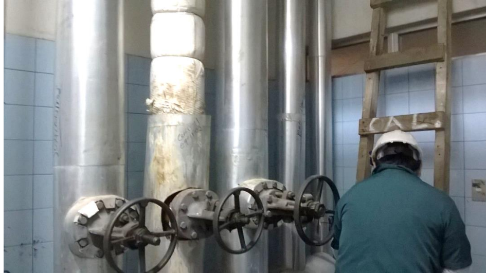
Figura 27. Manifold de distribución principal
