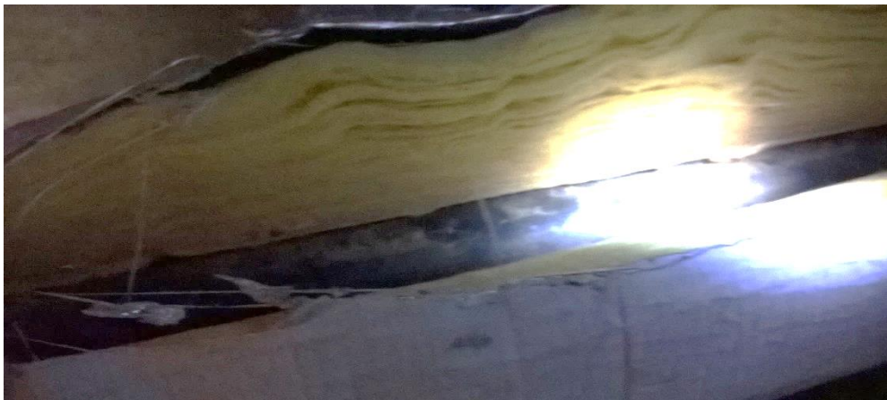
Figura 28. Sección de tubería expuesta (sin aislante)
