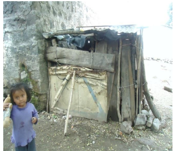
Figura 9. Servicios sanitarios en mal condiciones, en Chacayá, Santiago Atitlán, Sololá.
