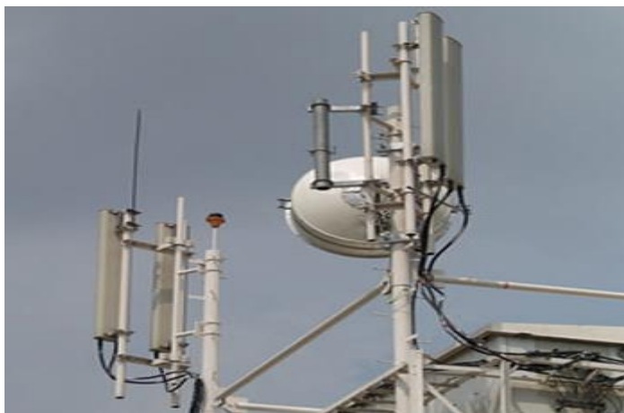
Figura 14. Antenas de comunicación WiMAX.
