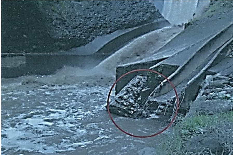
Figura 11. Daños al costado del canal de desfogue
