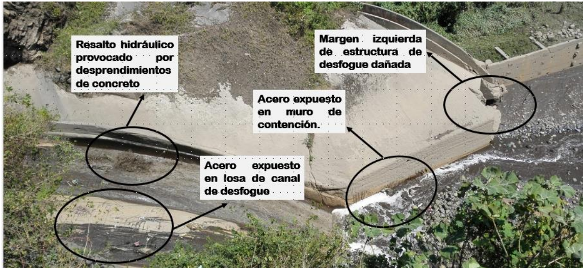
Figura 10. Daños identificados en canal de desfogue
