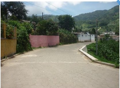
CALLES SECUNDARIA ADOQUINADA, CIRCULACION DOBLE VÍA, NO CUENTA CON ÁREA DE ACERA MINIMA.
