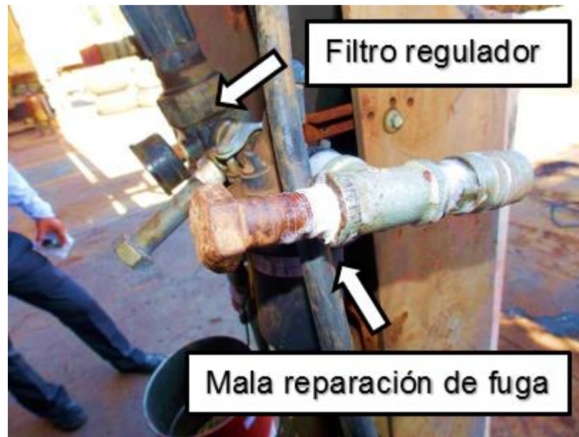
Figura 22. Mala reparación de fuga
