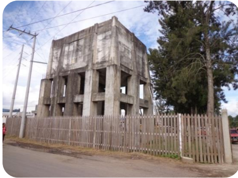
Al Oeste del terreno existe un tanque cisterna elevado que actualmente está en desuso y en estado de deterioro. IMAGEN NO. 9 - Foto Propia
