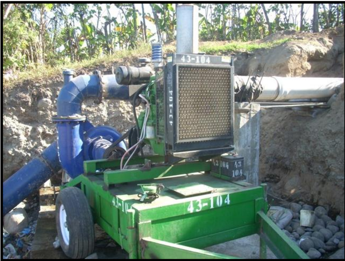
Figura 29: Estación de bombeo ya en operación.
