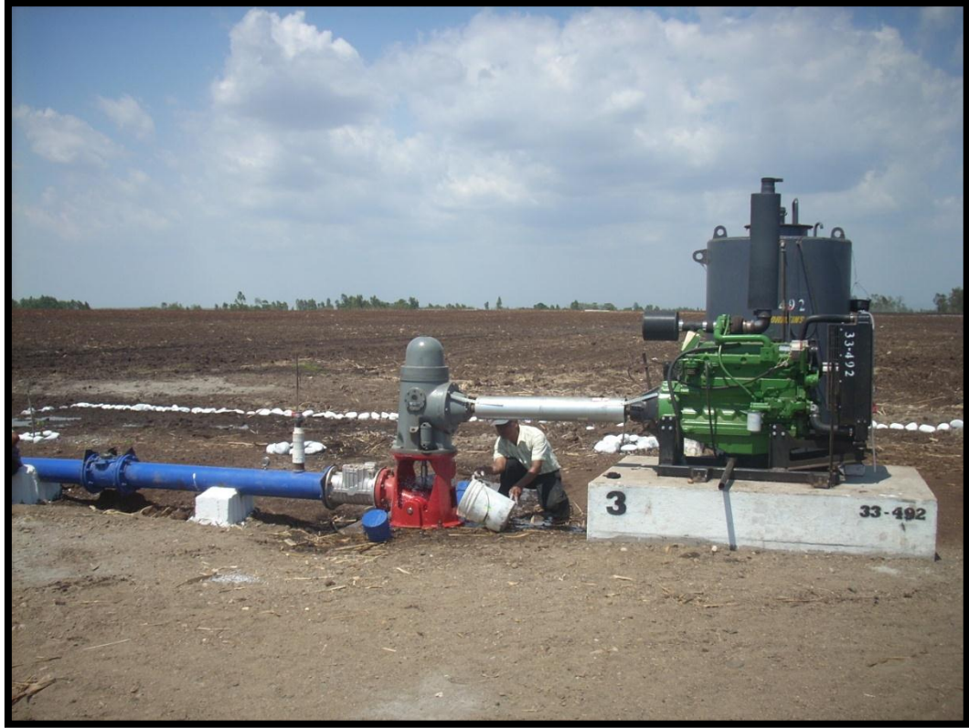
Figura 17: Módulo III de riego abastecido por pozo, entregado y en funcionamiento. Donde se aprecia de derecha a izquierda: base de concreto, motor, tanque de combustible, eje de cardan, cabezal de engrane, cabezal de descarga, válvula cheque, tubo de descarga y caudalímetro.
