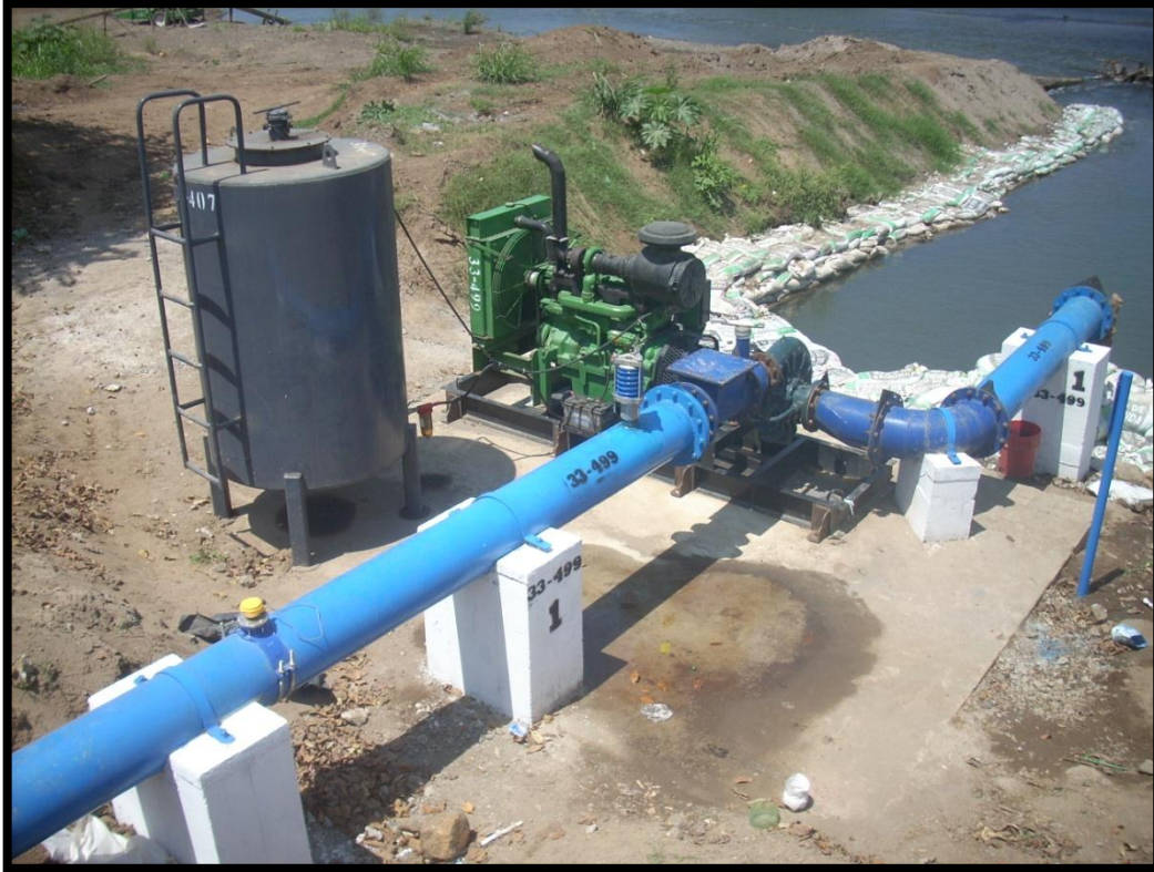
Figura 16: Ejemplo del módulo I de riego abastecido por el río Icán, entregado y en funcionamiento. Donde se aprecia: canal de llamada, succión y descarga, motor y bomba centrífuga, tanque de combustible y caudalímetro.
