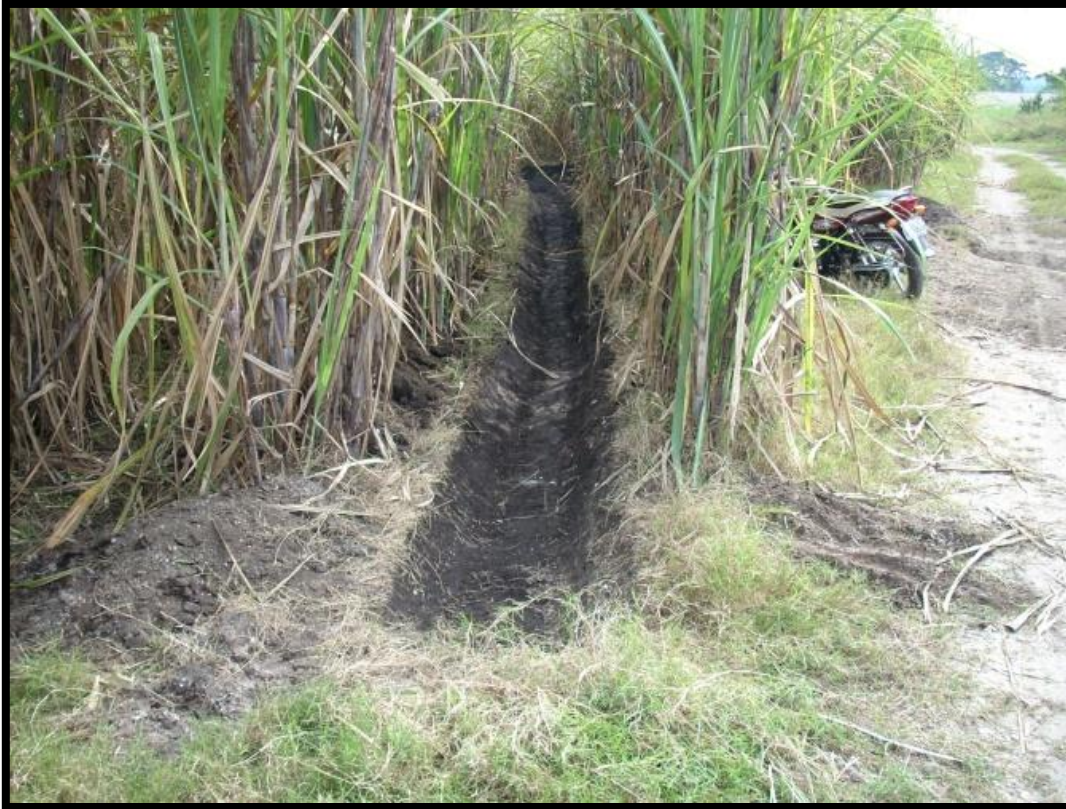
Figura 24: Trazo y elaboración de canales y cabeceras de riego para el proyecto
