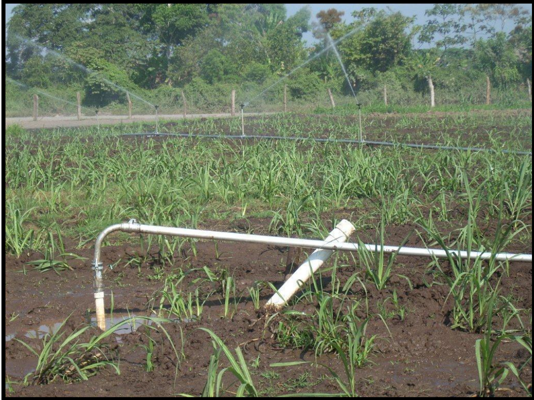
Figura 15: Hidrante de riego con una purga de lavado y aspersores en funcionamiento.
