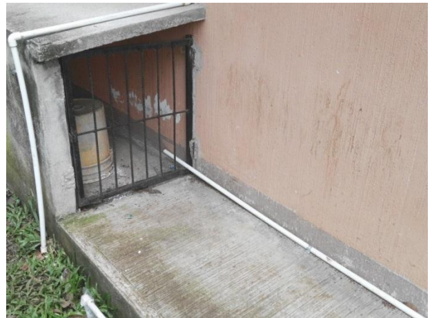
Fotografía No. 22. Jaula del compresor
