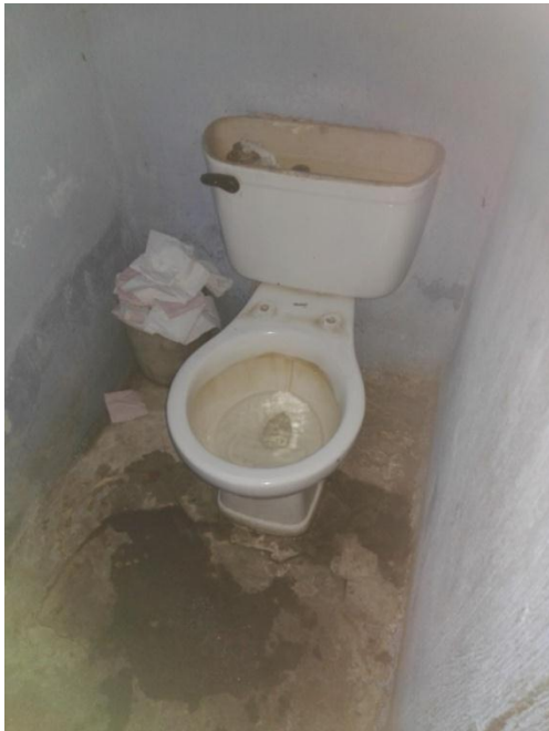
Fotografía No. 1. Estado inicial de los sanitarios
