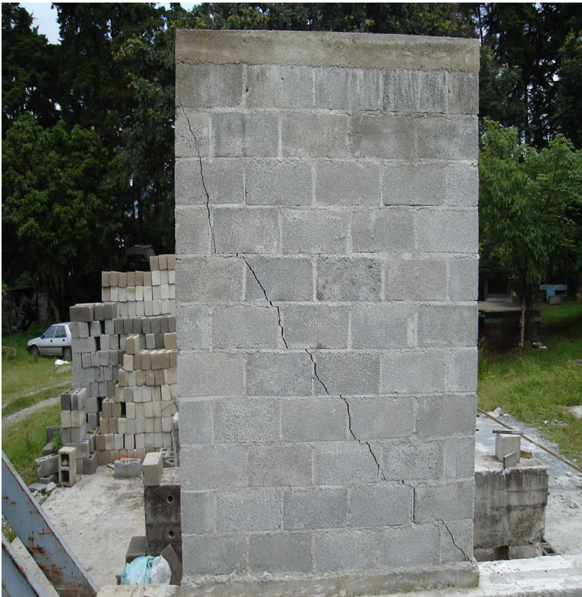
Falla por fricción corte & tensión diagonal
