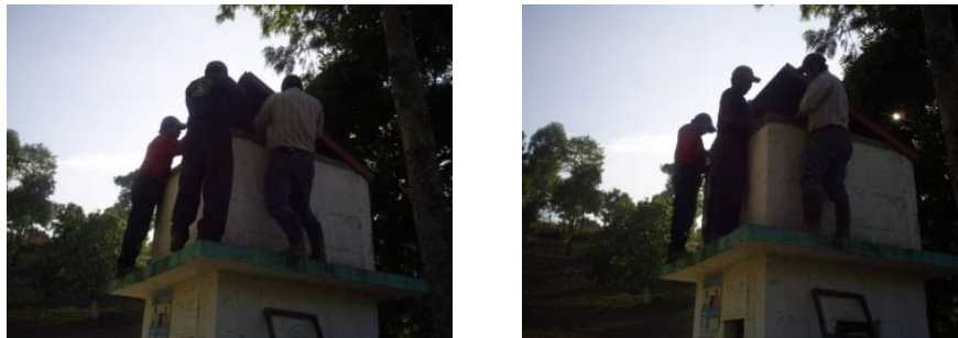
Figura 76 y 77. Cloración del agua
