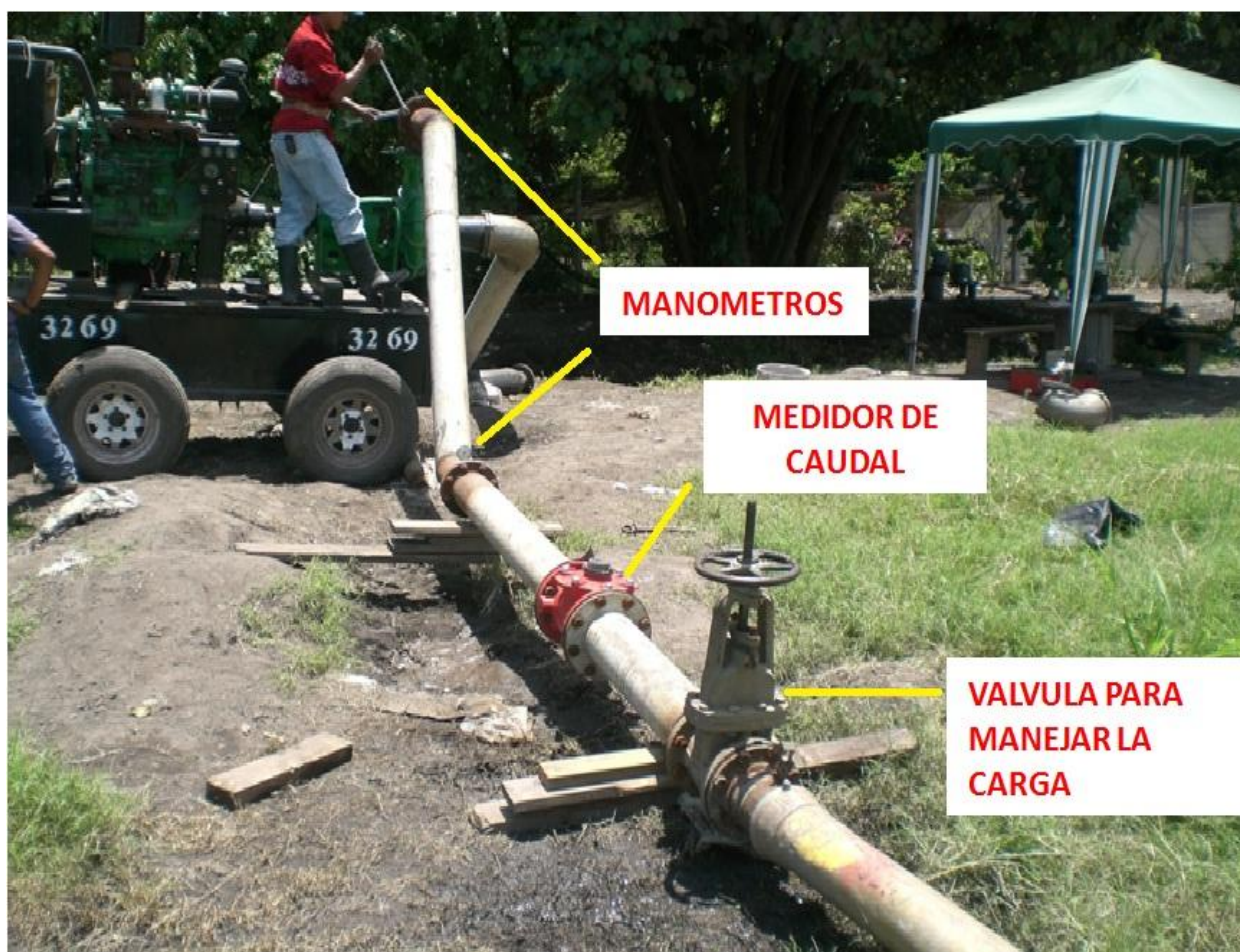
Figura 31. Accesorios para simular la carga hidráulica en la estación de prueba.
