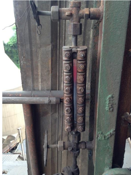
Medidor de nivel de agua
