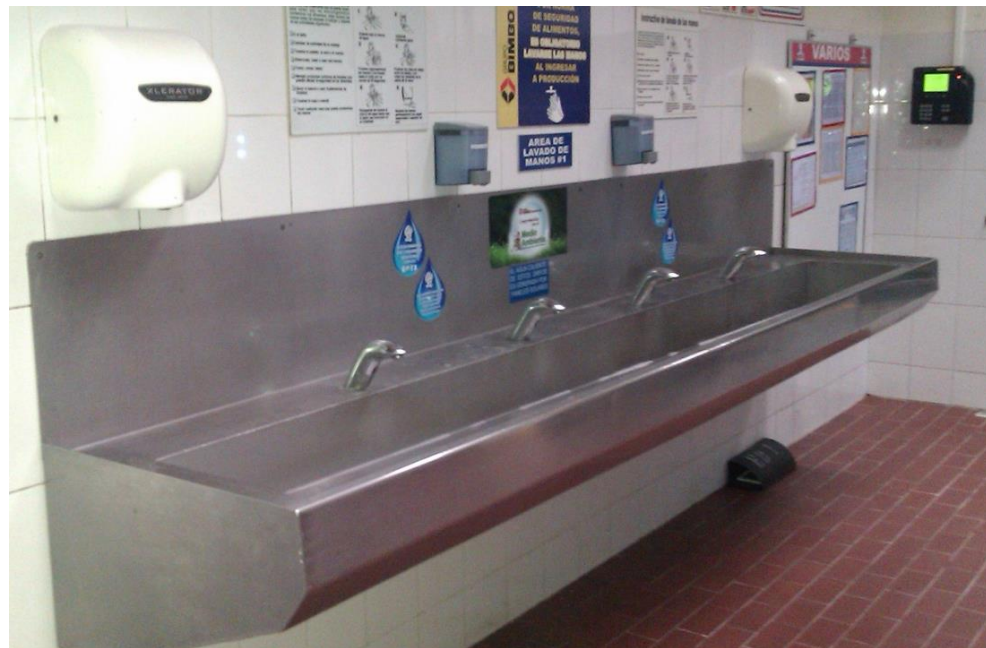
Figura 17. Lavamanos con sensor infrarrojo
