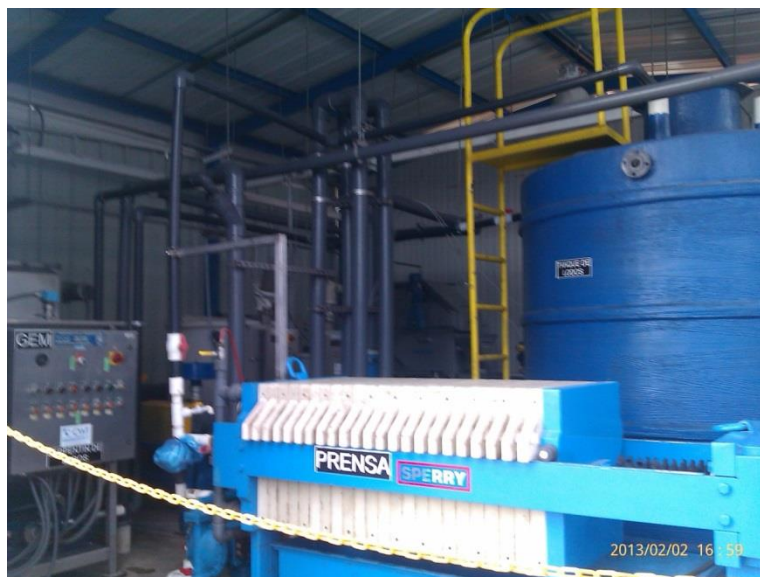
Fuente: Planta Panificadora.
