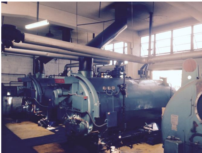
Figura 12. Cuarto de calderas
