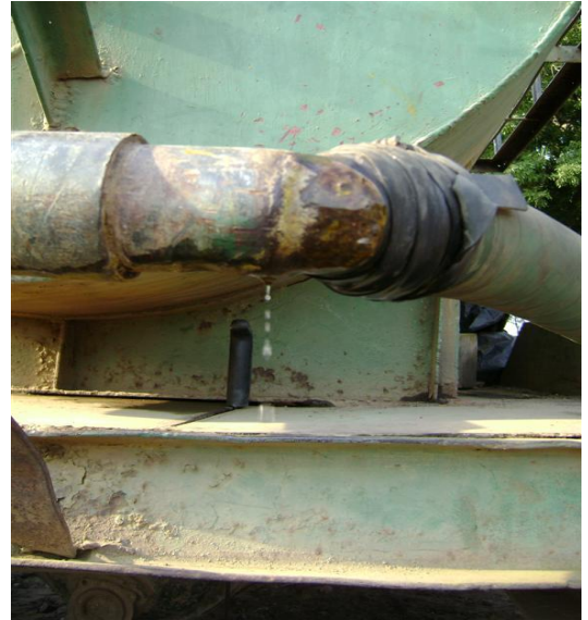
Figura 10.2: Tubería de la bomba.
