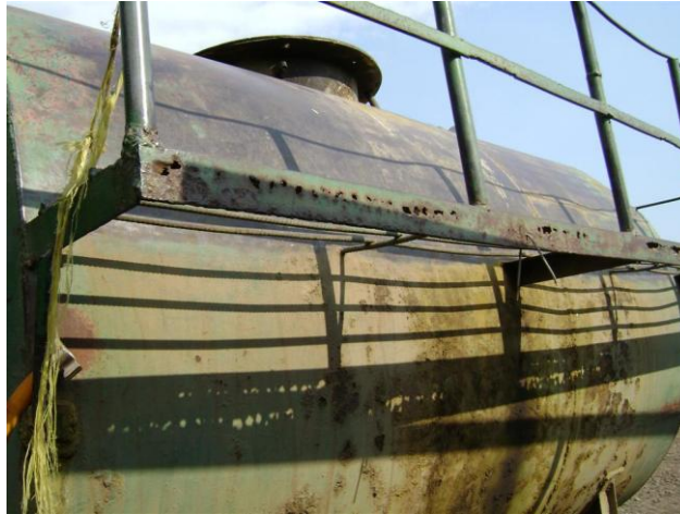
Figura 6: Corrosión en los tanques de agroquímicos.
