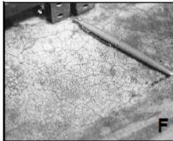
Figura 9. Resquebrajamiento o grietas aleatorias
