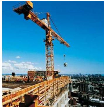
Figura 44. Grúa y tolva
