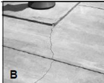
Figura 5. Grietas debidas a la colocación de juntas inapropiadas
