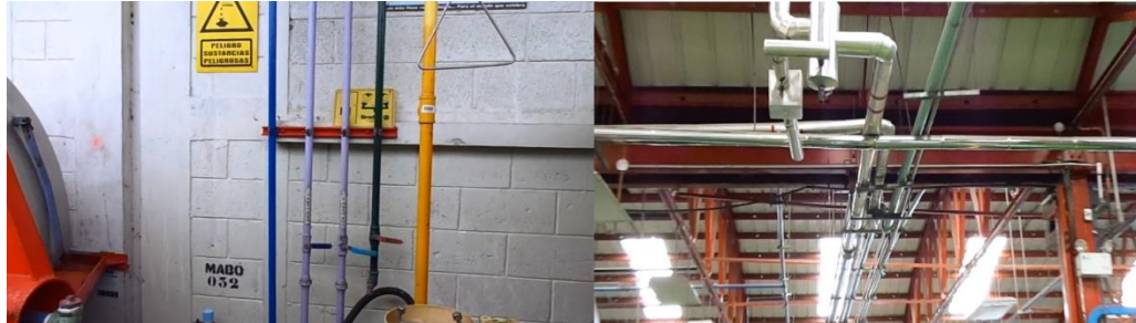
Figura 42. Tuberías que transportan soda cáustica
