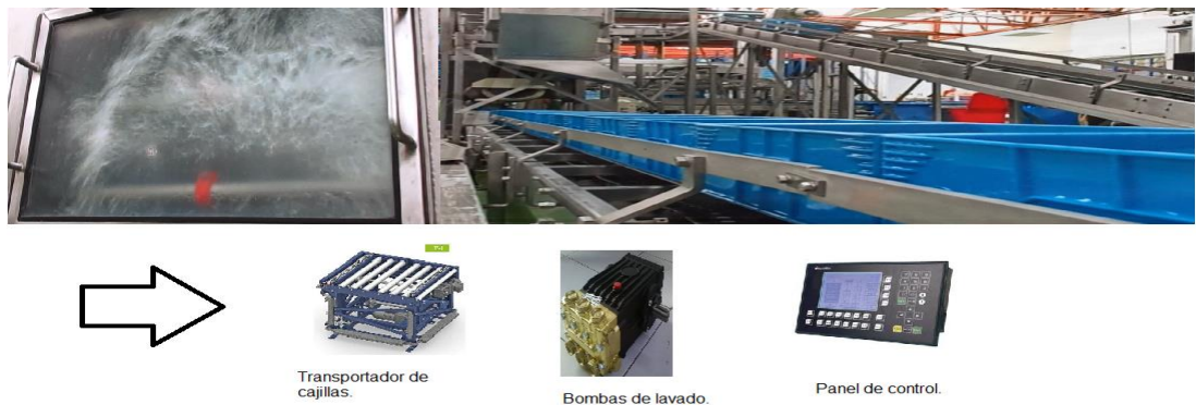
Figura 54. Modelo de mantenimiento preventivo de la lavadora de cajillas
