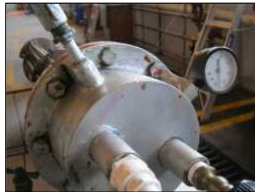
Fuga de agua a presión
