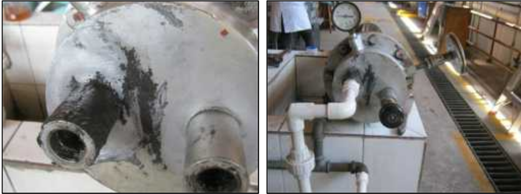
Sellado de fuga con Quicksteel (resina de epoxy) No pasa la prueba
