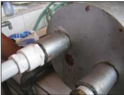
Fugas de agua por goteo
