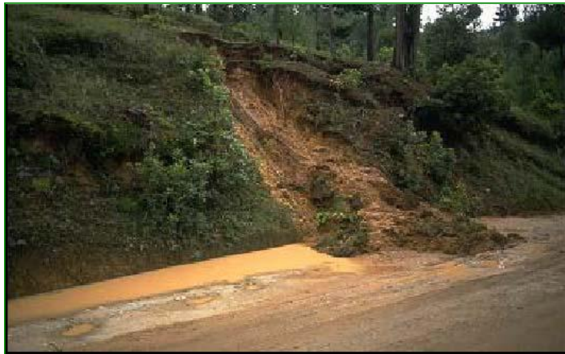
Figura 33 Las lluvias fuertes producen fallas en los taludes de corte y obstruyen las cunetas
